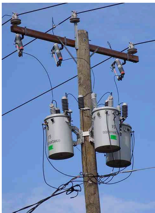
Rysunek 15.21 Transformatory wykorzystuje się m.in. do zamiany wysokich napięć w liniach przesyłowych na napięcie 220 V, używane w sieciach domowych. Źródło: modyfikacja pracy „Fortyseven”/Flickr
