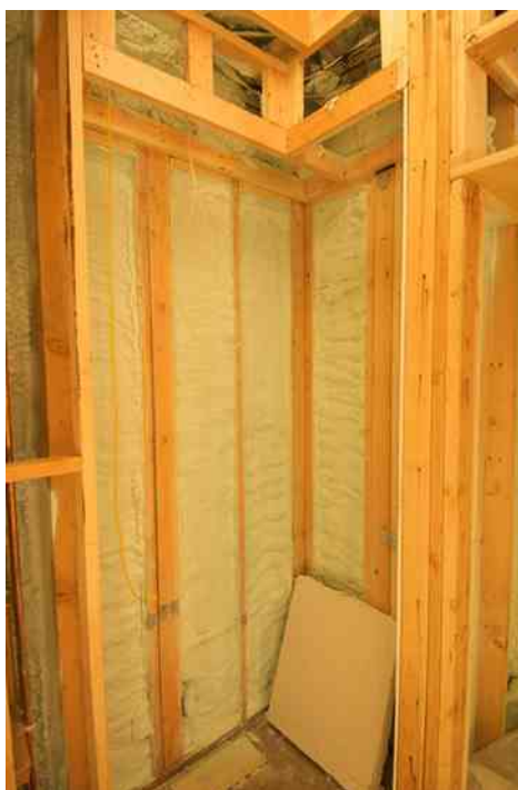
Rysunek 1.20 Izolację stosuje się, aby ograniczyć przewodzenie ciepła ze środka nagrzanego domu na zewnątrz (szczególnie zimą) i z zewnątrz, kiedy jest upał, do wnętrza domu (latem). Źródło: Giles Douglas
