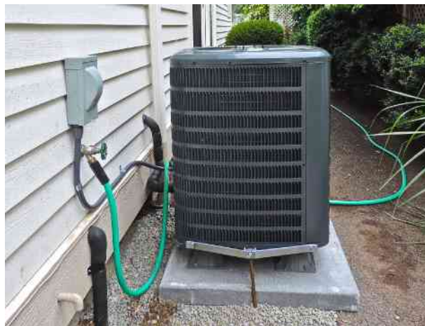
Rysunek 4.14 Zdjęcie pompy ciepła znajdującej się na zewnątrz budynku. Zdjęcie zostało zrobione w obszarze o ciepłym klimacie, gdzie używanie takiej pompy ciepła jest opłacalne. Źródło: modyfikacja zdjęcia Petera Stevensa
